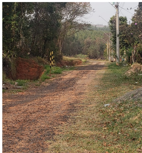
Imagem 2: Caixas de contenção construídas no Distrito de Brasília Paulista (Piratininga - SP)
